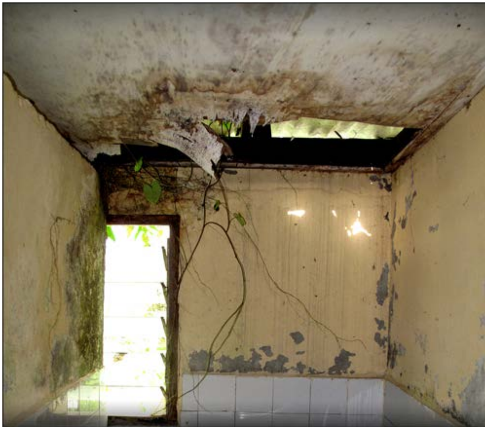
Het dak van het hulpcentrum is een vergiet
