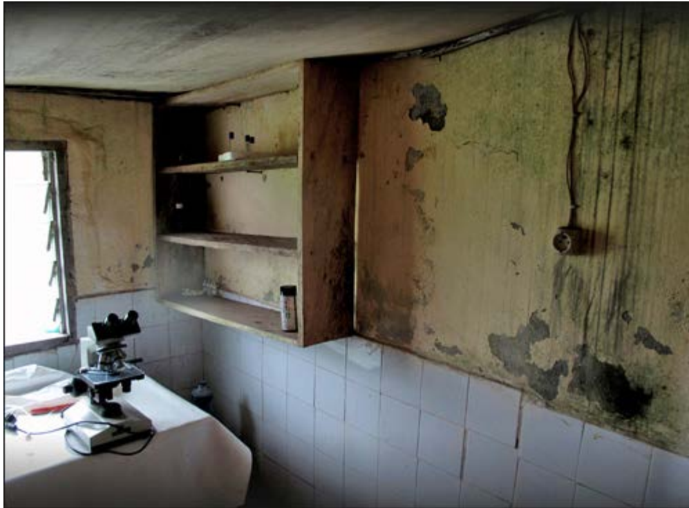
Schadelijke schimmels bedekken de muren van het hulpcentrum
